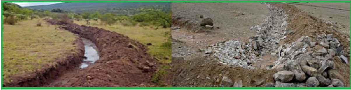
Fig. 7 Se ilustra una zanja de derivación recién excavada a la izquierda y una vez cabeceada para evitar arrastre de sedimentos a la derecha.
