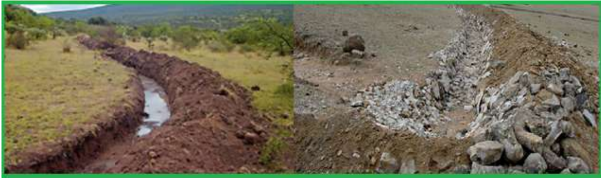
Fig. 10 Se ilustra una zanja de derivación recién excavada a la izquierda y una vez cabeceada para evitar arrastre de sedimentos a la derecha.
